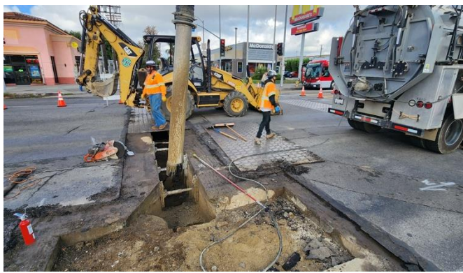
Restauración de la línea de agua abandonada en Blythe St y Van Nuys Blvd.
