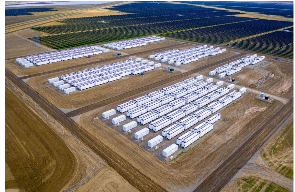
MN8 battery energy storage & solar panels in Stratford, CA Kings County (Credit: MN8 Energy) Almacenamiento de energía en baterías y paneles solares de MN8 en Stratford, California, Condado de Kings (Crédito: MN8 Energy)
