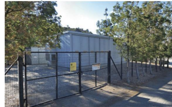
Subestación eléctrica de tracción
