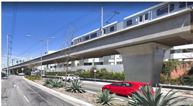
Estructuras Aéreas del Tren Ligero (LRT) (ver áreas resaltadas en verde en el mapa)
