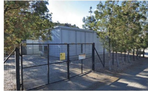
Subestaciones eléctricas de tracción (TPSS)
