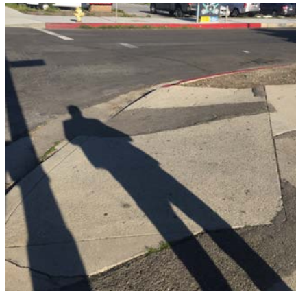
Uneven sidewalk ramps
