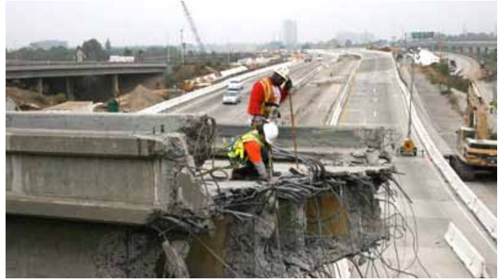
공사 활동은 유해 폐기물을 초래할 수 있으며, 이러한 물질은 적절한 처분 시설에서 처분될 것입니다.
