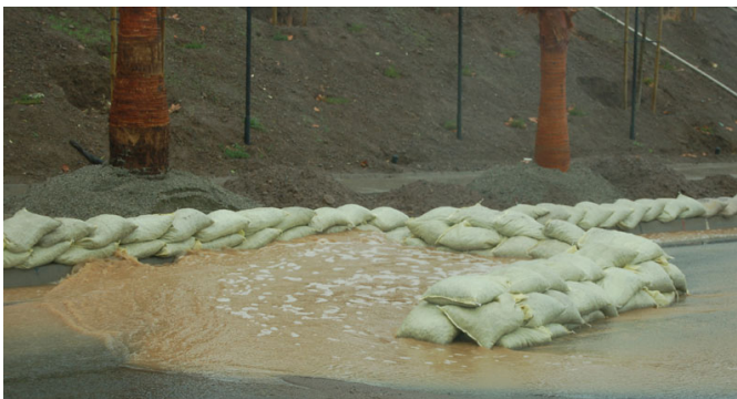
Ang pagkontrol sa umaagos na tubig-ulan sa panahon ng konstruksyon ay napakahalaga sa pagpapanatili sa kalidad ng tubig sa pinag-aaralang lugar.
