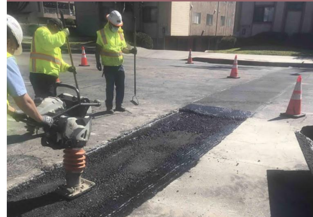
Restauración del pavimento de las calles cerca de Van Nuys Bl y Arleta Av
