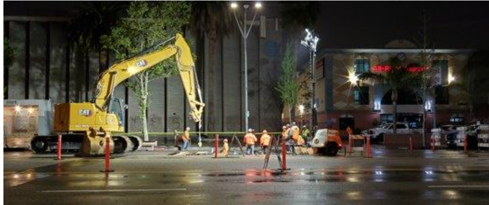
Instalación de bóvedas a lo largo de Van Nuys Bl entre Vanowen St y Vose St
