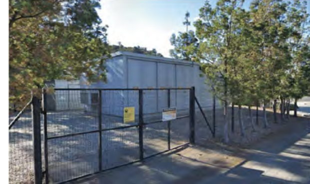
Subestación Eléctrica de Tracción
