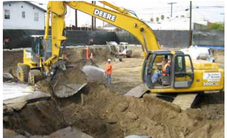
La construcción del proyecto da como resultado una variedad de impactos a corto plazo, especialmente relacionados con la calidad del aire, ruido e impacto visual del entorno. Se implementaría un programa extensivo de medidas de mitigación de la construcción para cualquiera de las alternativas de construir.
